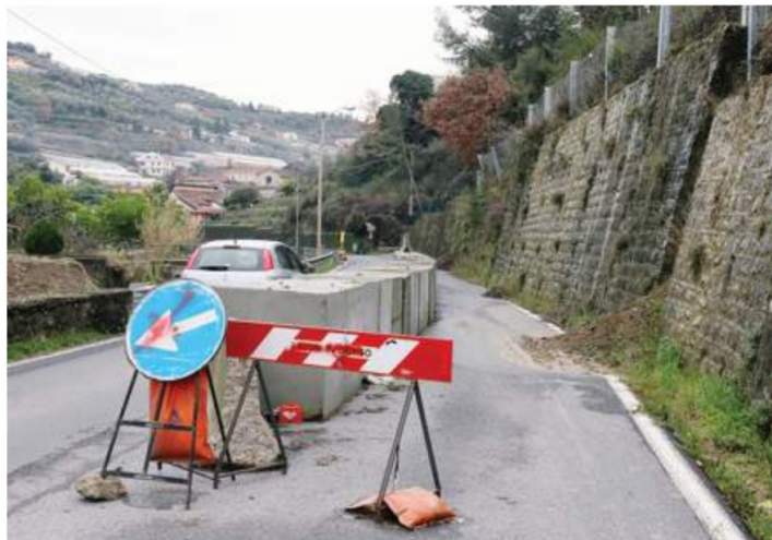
Frana e muro pericolante lungo la strada che conduce a San Biagio della Cima
